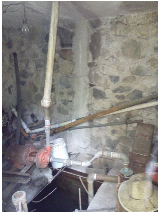
Figura 53. Puesto de bombeo del Manantial de Chalchihuapan.
